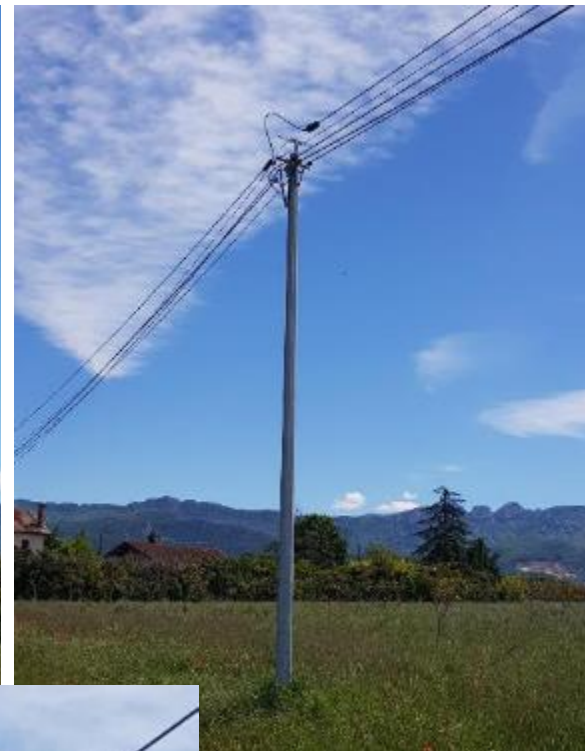
Poteau télécom métal
